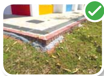
Sealed crevices Celahan ditutup secara sempurna
