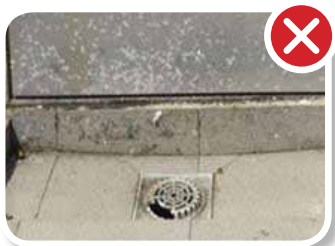
Broken plastic gully trap Penutup longkang plastik yang rosak
